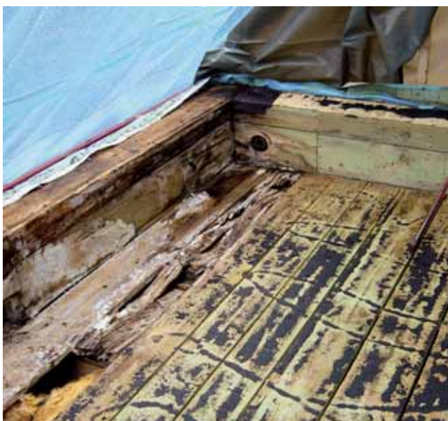
Abb. 6: Zerstörung der Attikabekleidung und der angrenzenden Dachschalung. Breite Fugen zwischen den Brettern lassen auf hohe Einbaufeuchten schließen.. Quelle: [Martin Mohrmann, 2006]
