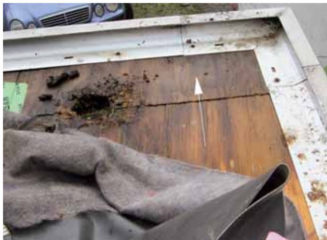
Abb. 3: Niederschläge laufen seitlich am Flachdachgully vorbei.
