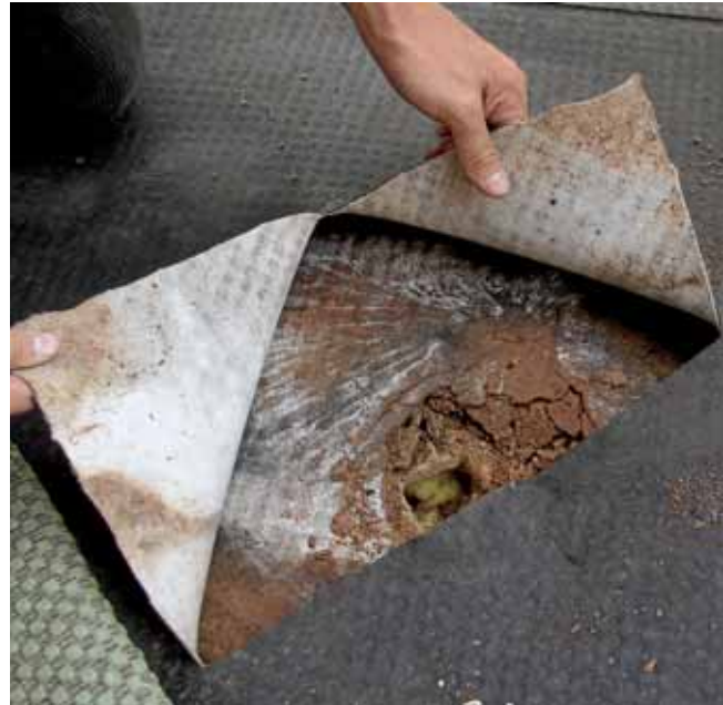
Abb. 1: Böse Überraschung unter der Dachhaut
