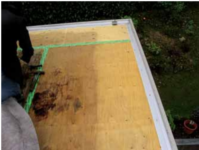
Abb. 5: Der ungedämmte Dachrand zeichnet sich deutlich durch Feuchteunterschiede in der Dachschalung ab. Quelle: [Burkhard Walter, 2006]
