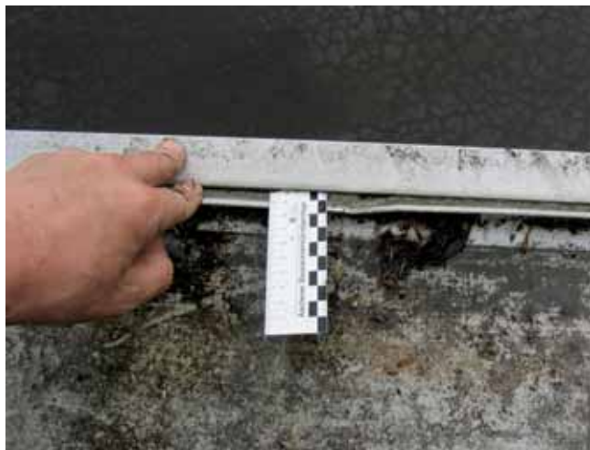
Abb. 2: Mangelhafte Entwässerung über Wasserspeier. Der Dachrand wird bei Stauwasser hinterlaufen.
