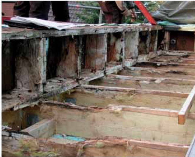
Abb. 7: Vollständige Zerstörung der Attika sowie Teile der Dachbalken. Quelle: [Martin Mohrmann, 2006]
